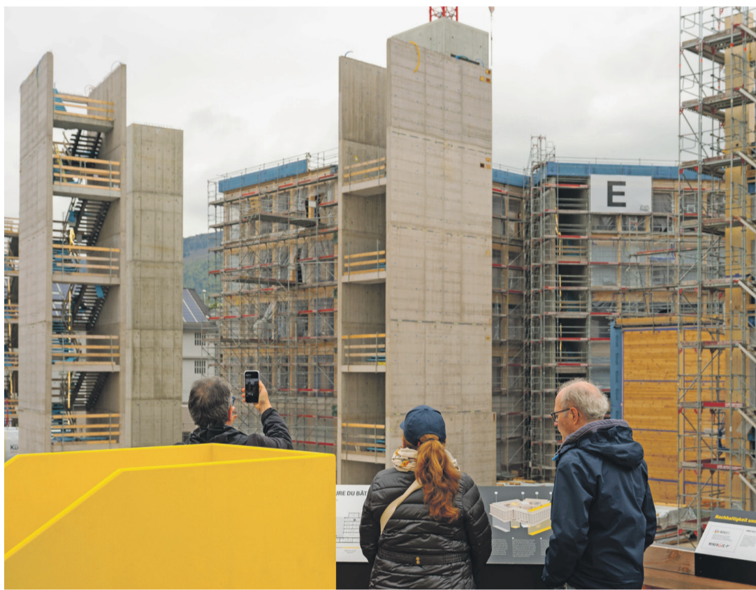
Von der Terrasse aus erhält man einen etwas anderen Blick auf die Baustelle.
